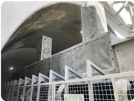
Die korrekte Installation des Systems gewährleistet eine optimale Leistung.
